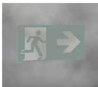
Señal de emergencia mal iluminada
